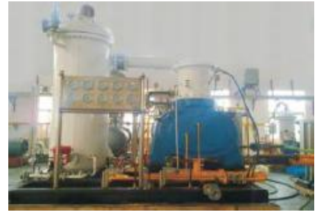
螺杆压缩机组
