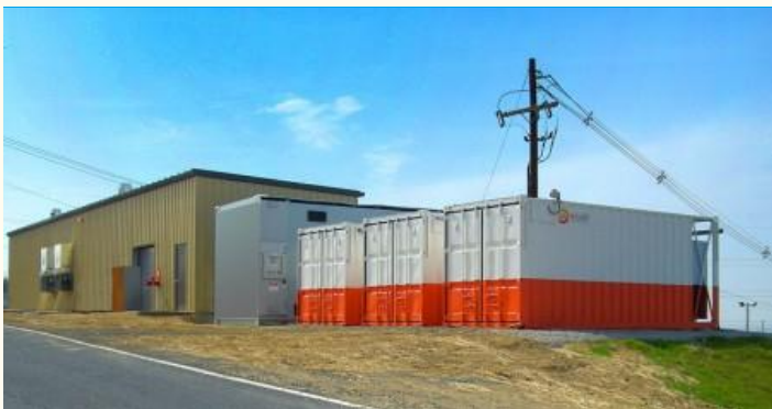
图表 14：铅碳电池储能海外示范项目（一）
