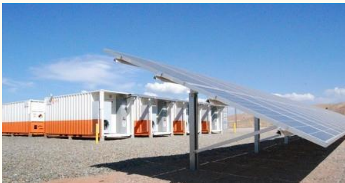
图表 15：铅碳电池储能海外示范项目（二）
