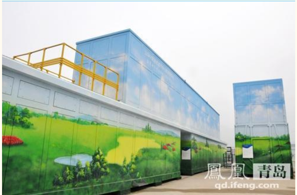
图表 17: 110kV 城市中心模块化智能变电站
