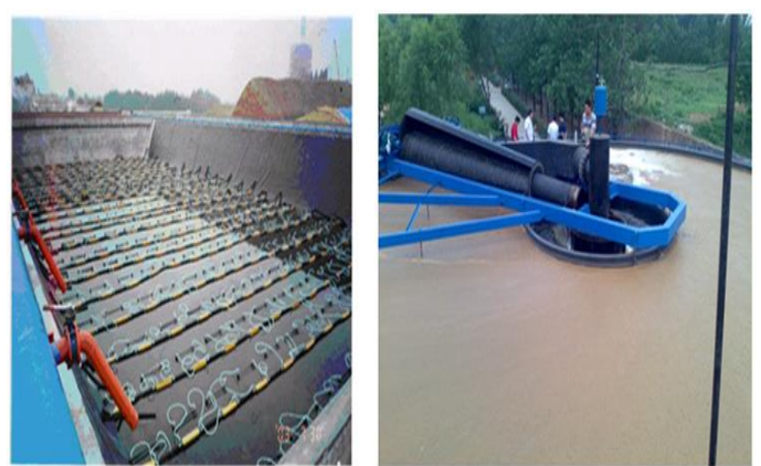
图 55：污水处理曝气池、高效浅层气浮设备
