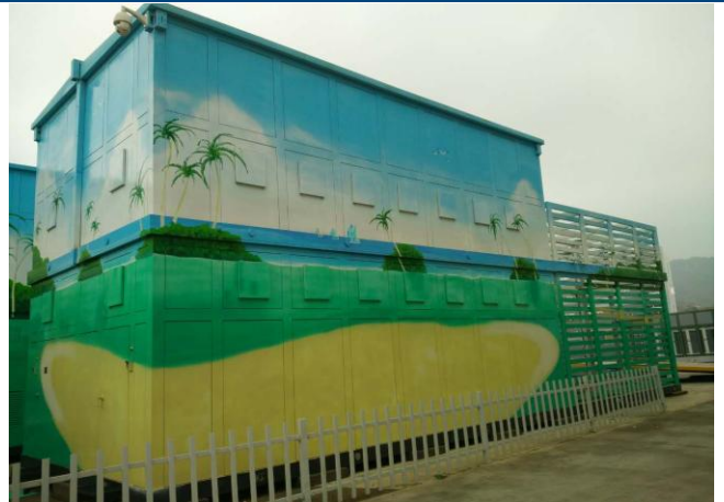
图 12:110KV 配送式智能变电站
