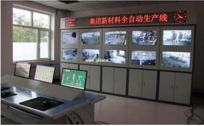
图 4：防腐油漆全自动生产线
