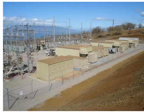
图 10：美国 Auwahi 风力发电储能项目
