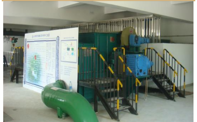
图 2：某湖区水环境治理项目设备图
