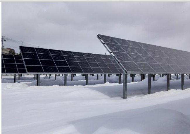
图 10 公司自建电站示范项目
