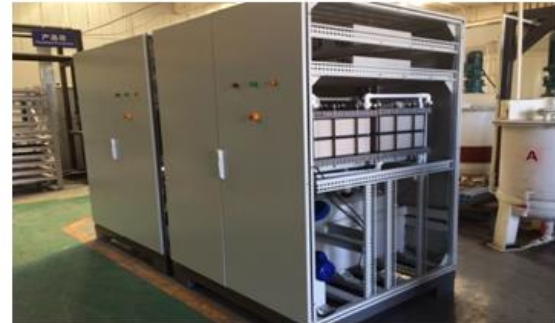
特变电工股份储能微电网项目
