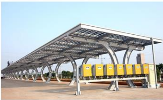
青海省光储一体化电动汽车充电站项目
