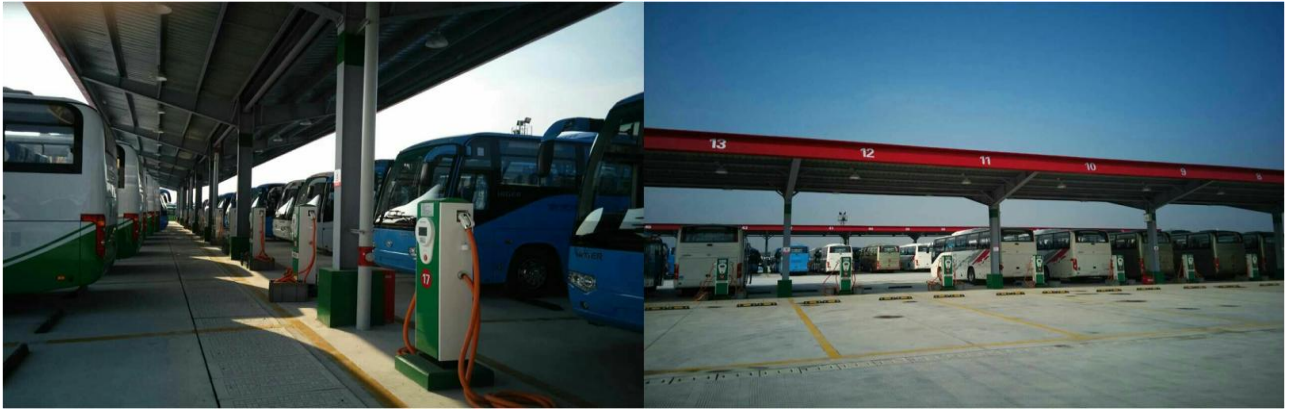
图 13：和顺承建金龙电动客车充电站
