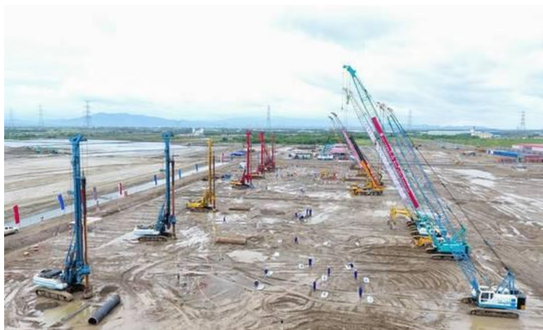
图表 1：印尼迄今为止最大规模水电站爪哇7号2×1050MW 燃煤发电项目施工现场
