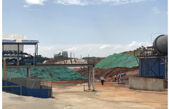
图 4: 博世科南化项目 (化学气味明显)
