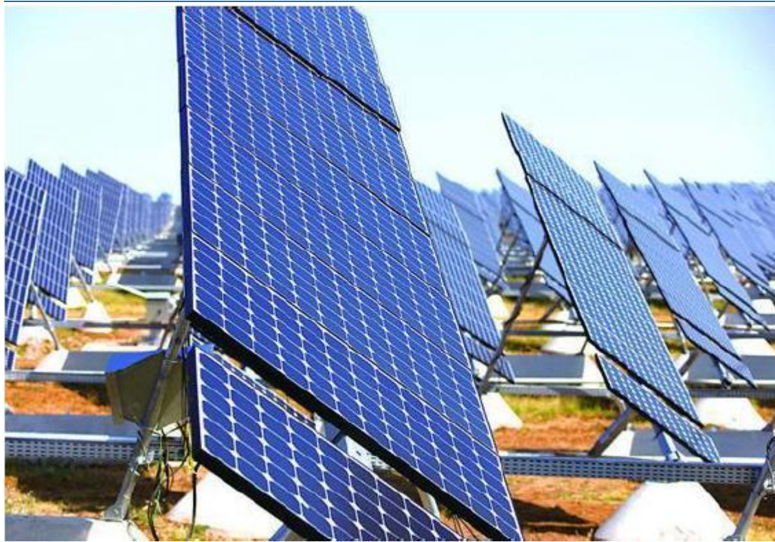
图 28：光伏系统及精密金属安装支架
