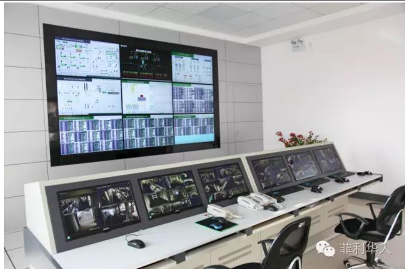
图 16: 智慧工厂中央控制系统
