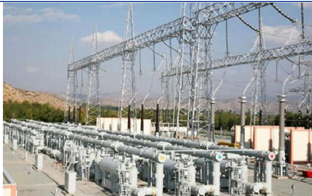
图 3：平高电气 800 千伏 GIS
