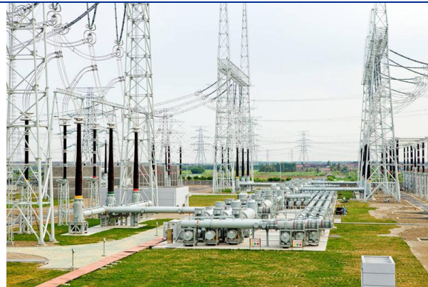
图 4：平高电气 1100 千伏 GIS（皖电东送沪西站）
