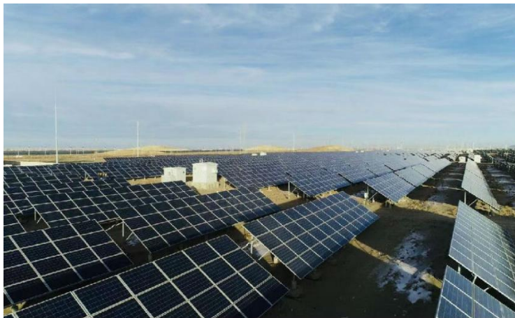
图7:海西州格尔木市国家第三批“光伏领跑者”项目
