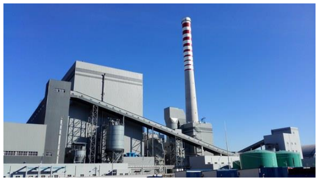
图 25：神华神东电力山西河曲发电有限公司 2 × 350MW 机组烟气超低排放治理工程
