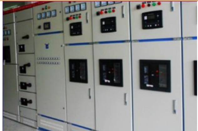
图 17: 公司电力开关设备及元器件产品
