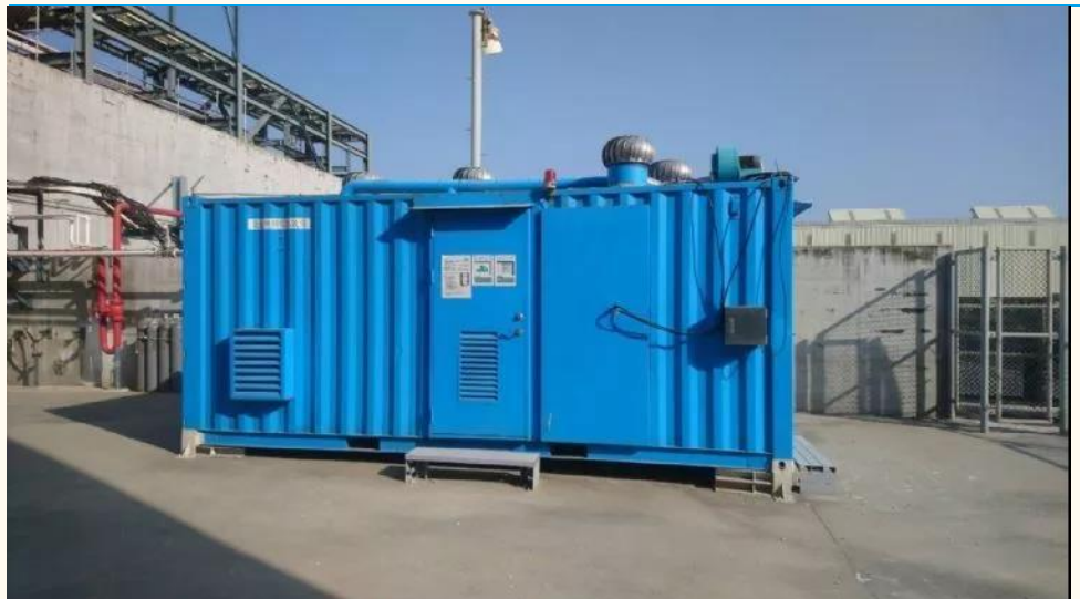
图表 5：台湾首座商用 50kW 燃料电池发电站系统
