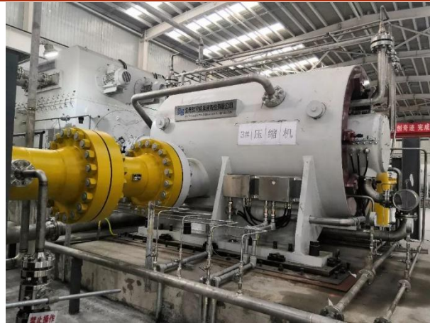
图1：沈鼓配套西气东输中卫联络压气站 20MW 级电驱压缩机组
