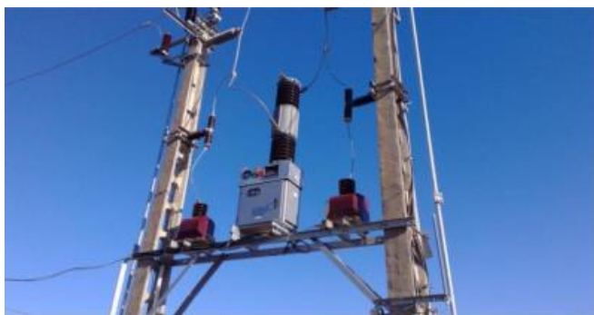
图表 56: 27.5kv 柱上开关站运行现场
