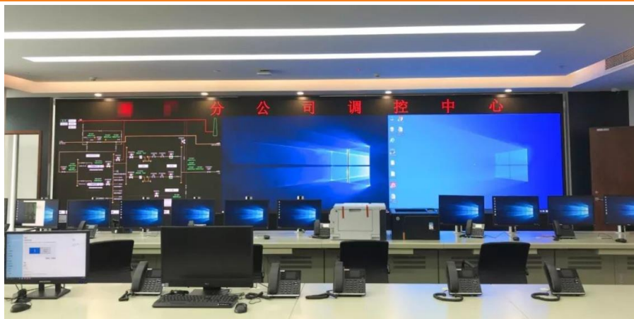
图 12：中石化分公司调度中心超高清项目实景图
