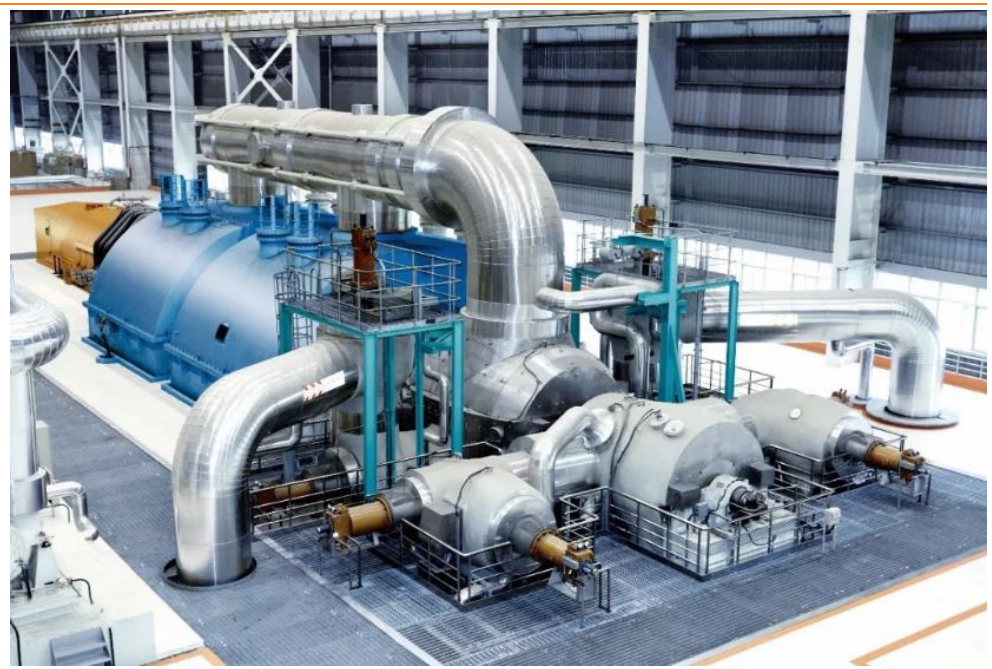
图 6：我国首套百万千瓦级超超临界机组在浙江玉环发电厂投运
