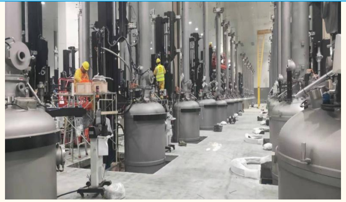
图表 40: 2019 年 10 月 10 日, 弘元新材 5GW 单晶项目第一台单晶炉成功安装
