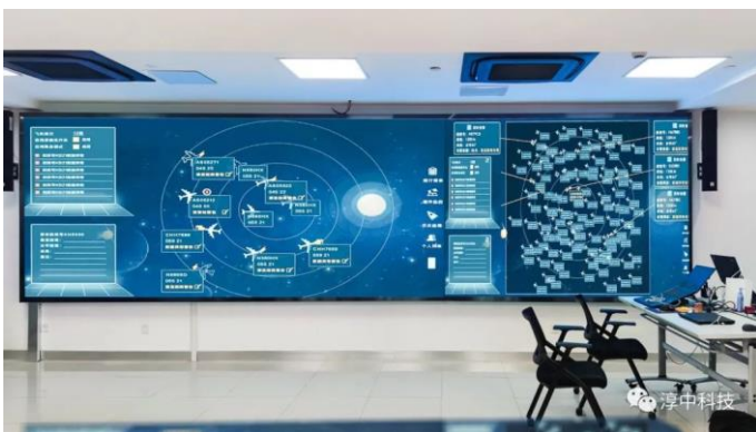
图13：淳中科技助力中国民航某空中交通管理局构建空管自动化系统
