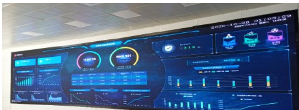
云南神火园区监控中心
