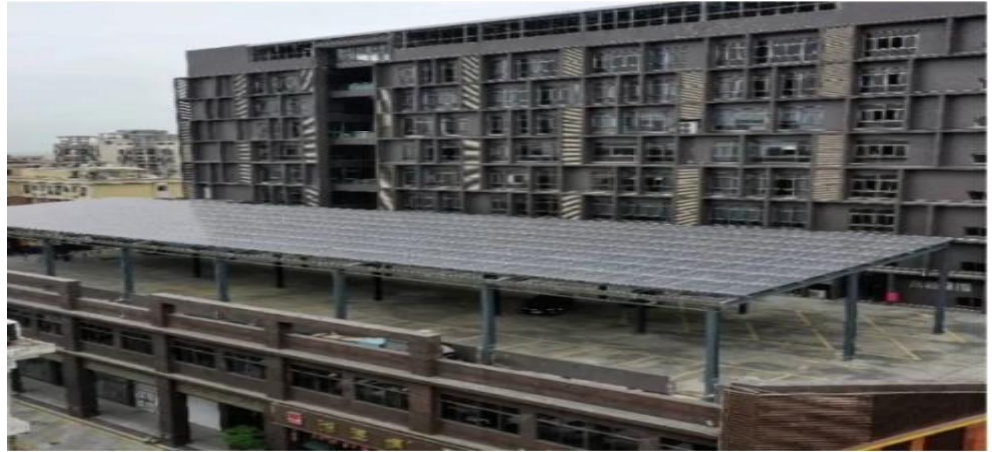
图 13：中山某典型 BIPV 车棚项目
