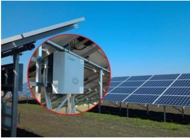
图 5：光伏逆变器装置
