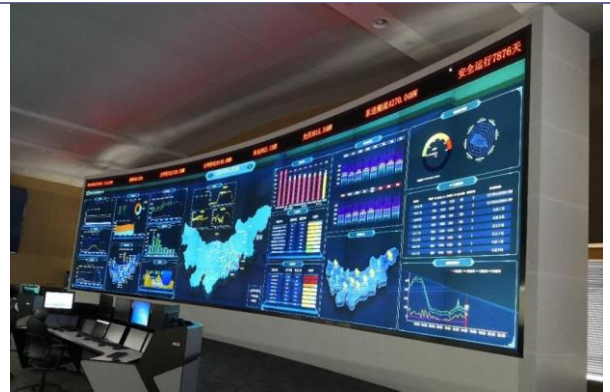
图表 29：电力调度指挥中心现场图
