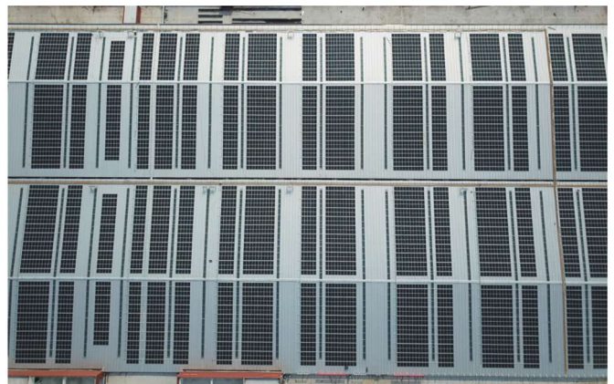
图表 45: 公司首个新建厂房 BIPV 光伏发电项目
