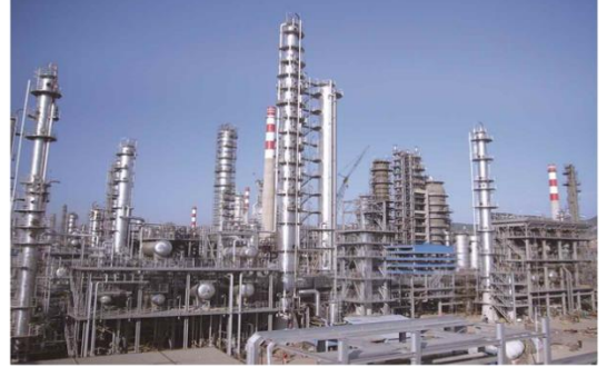
中海油惠州 1200 万吨炼油裂催化项目
