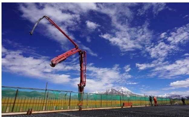
图 15：阿里-藏中互联工程仁嘎、仲巴 220kV 变电站储能项目
