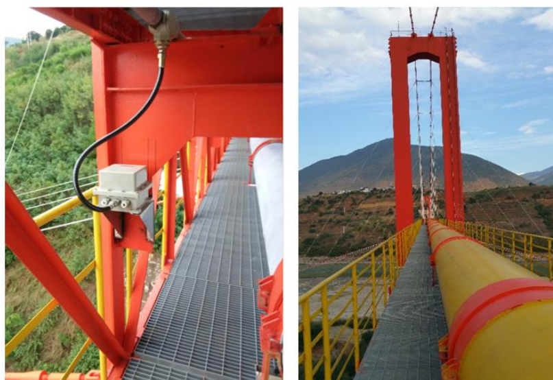
图 21: 中缅油气管道怒江跨越大桥安全监测系统
