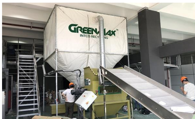
图 36: Greenmax A 系列设备于上海城投项目运行实况
