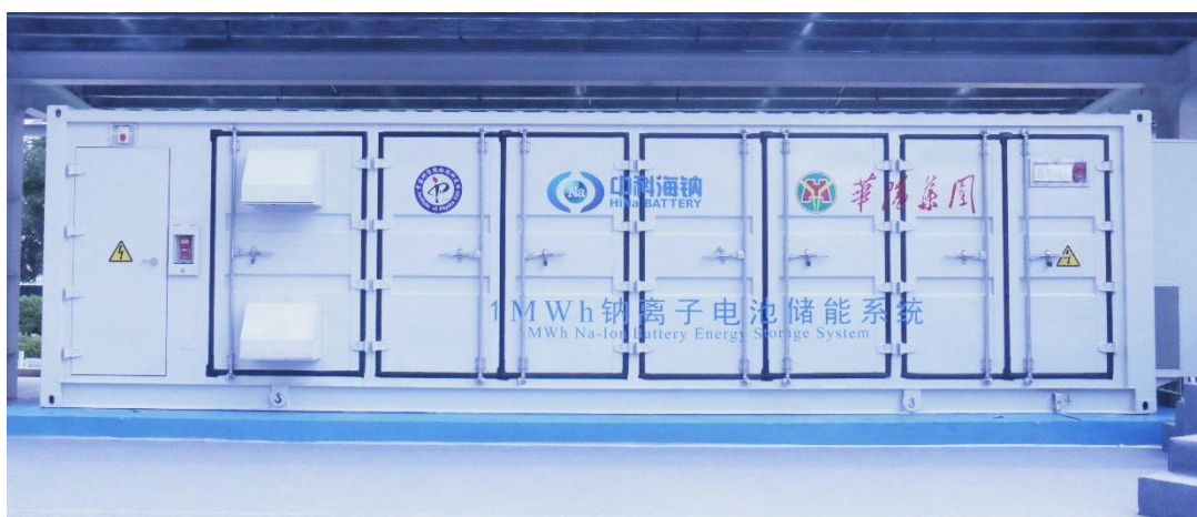
图表 43: 1MWh 钠离子电池储能系统
