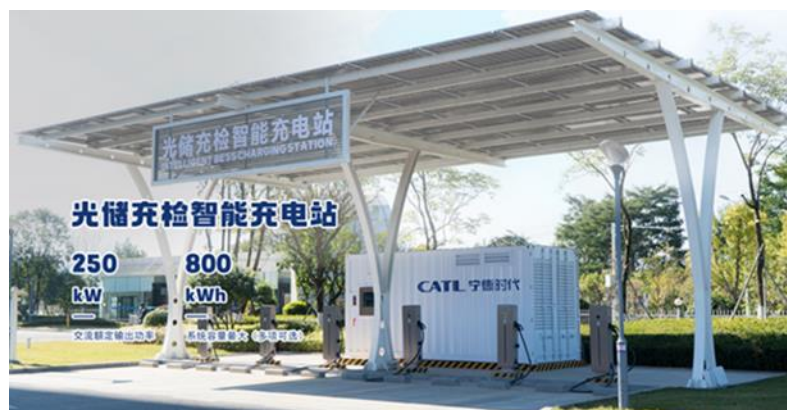
图表 28: 光储充检一体化智能充电站
