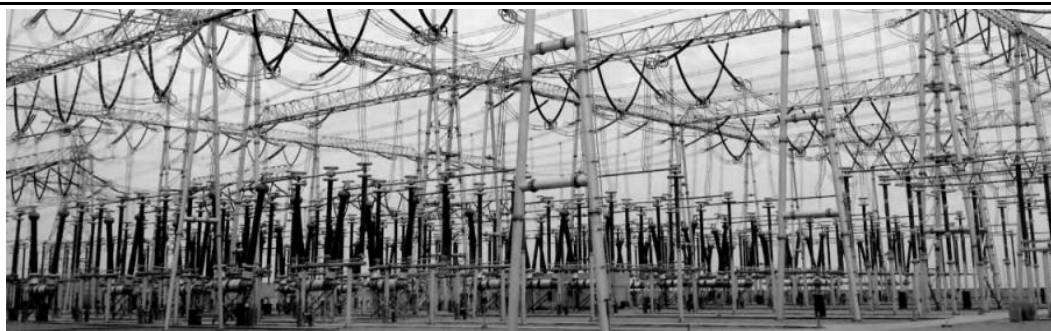
图 25: 750 kV 沙洲站—全部电站绝缘子均为硅橡胶复合绝缘子
