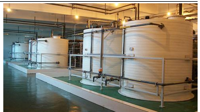
图 7：北京普能液流电池系统供应国家风光储输示范项目
