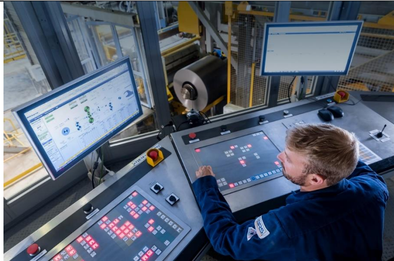
图表 94 大河钢铁 The BEAST 工业运营平台
