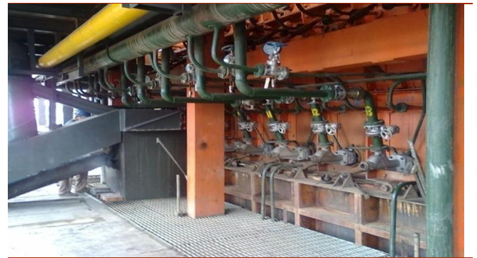
图2：瓦纽科夫炉设备现场图片（侧吹喷枪部分）
