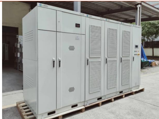
图38: 10kV 高压静止无功补偿装置 (SVG)
