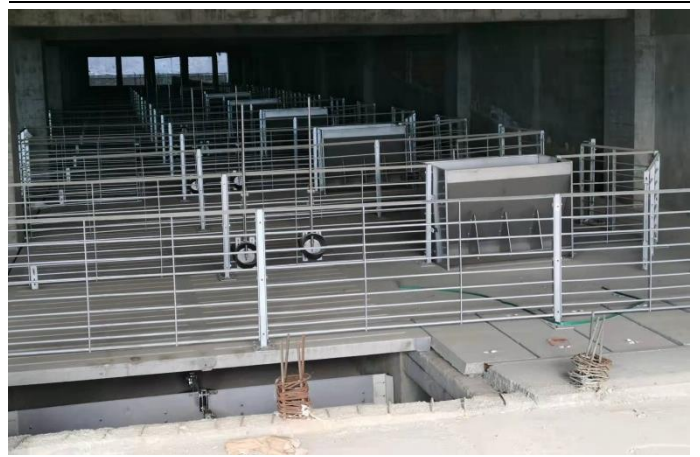
图18: “德昌项目”内部饲喂教槽已陆续安装
