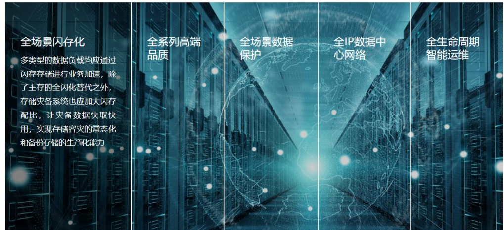
图 20: 华为 OceanStor 存储全闪存数据中心
