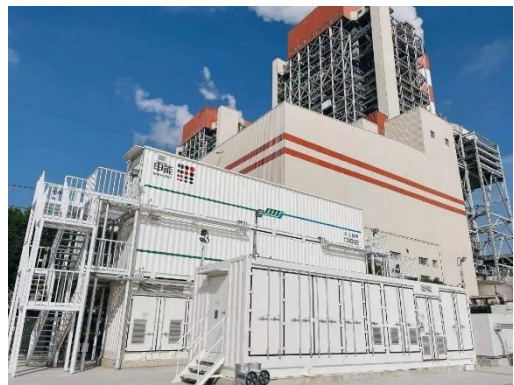
图38: 2020年外三电厂“火储联合运行”项目投产
