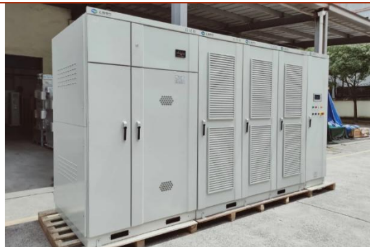
图19：10kV 高压静止无功补偿装置（SVG）
