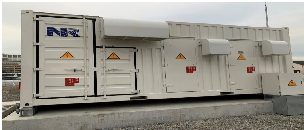
图32: 南瑞继保储能解决方案持续中标日本储能项目
