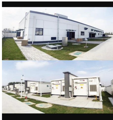
图 24：国网综能电化学储能项目示例（江苏淮安储能电站项目）
