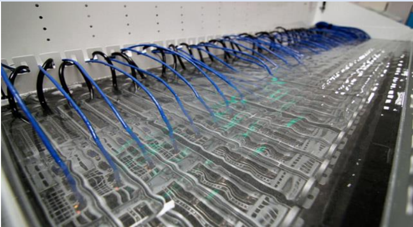
图：数据中心浸没式液冷系统
