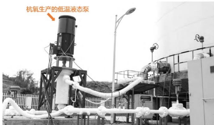
图 52：杭氧生产的 60000m 3 /h、8MPa 高压液氧泵正在经过 72 小时连续运转测试
