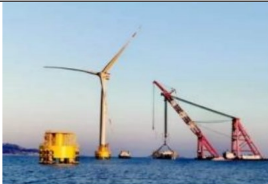
图22：“亨通一航”号海上风电作业平台
